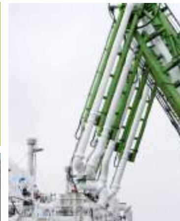
Bras de déchargement à Montoir de Bretagne, France
