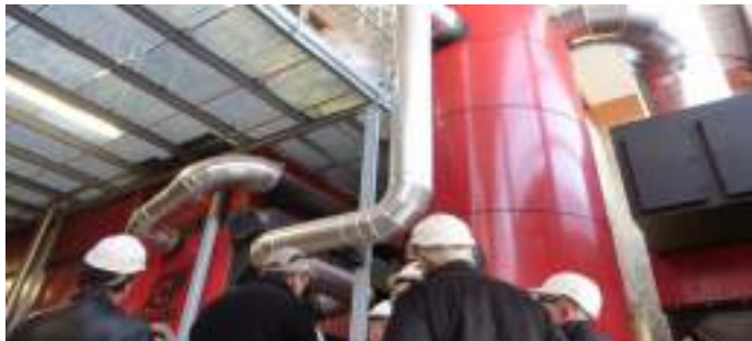
Visite du réseau de chaleur de Bourges
