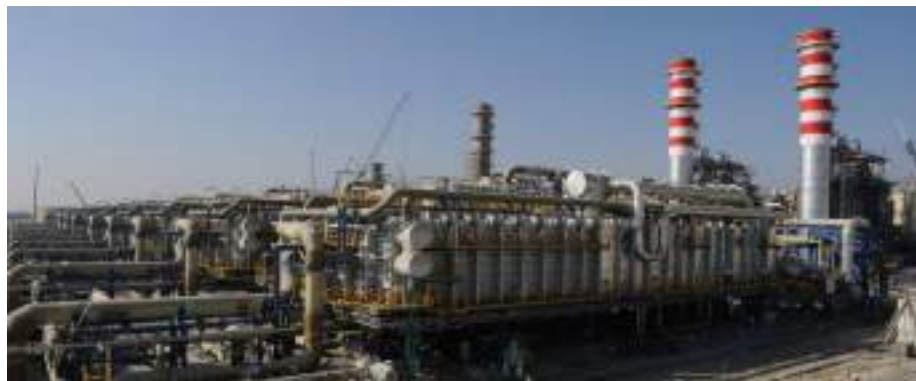
Centrale de Fujairah, Emirats Arabes Unis
