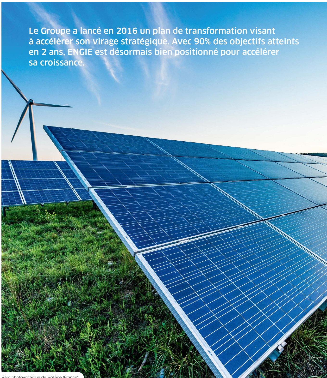
Parc photovoltaïque de Bollène (France)
