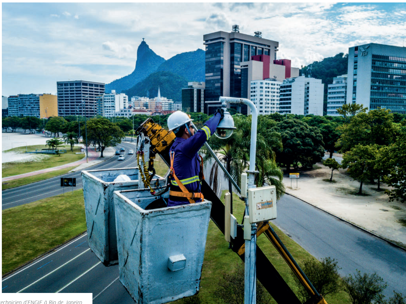
Un technicien d'ENGIE à Rio de Janeiro
