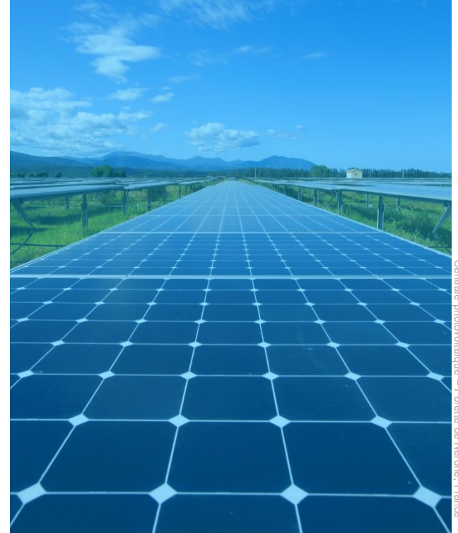
Centrale photovoltaïque – Portet de Néron, France
