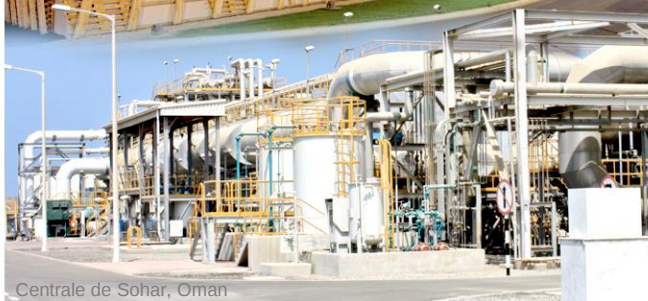
Centrale de Sohar, Oman
