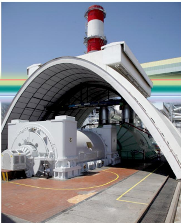
Dunamenti, Hongrie, CCGT
