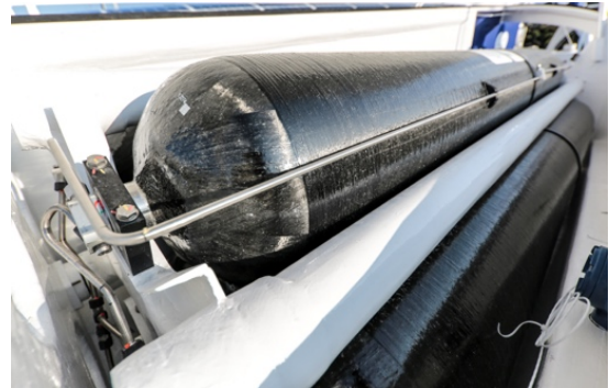
Les réservoirs d'hydrogène
