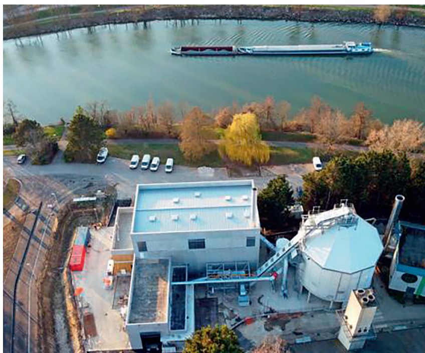
Le réseau de chaleur de Compiègne est désormais alimenté à 65 % d'énergie renouvelable et locale grâce à la biomasse.
