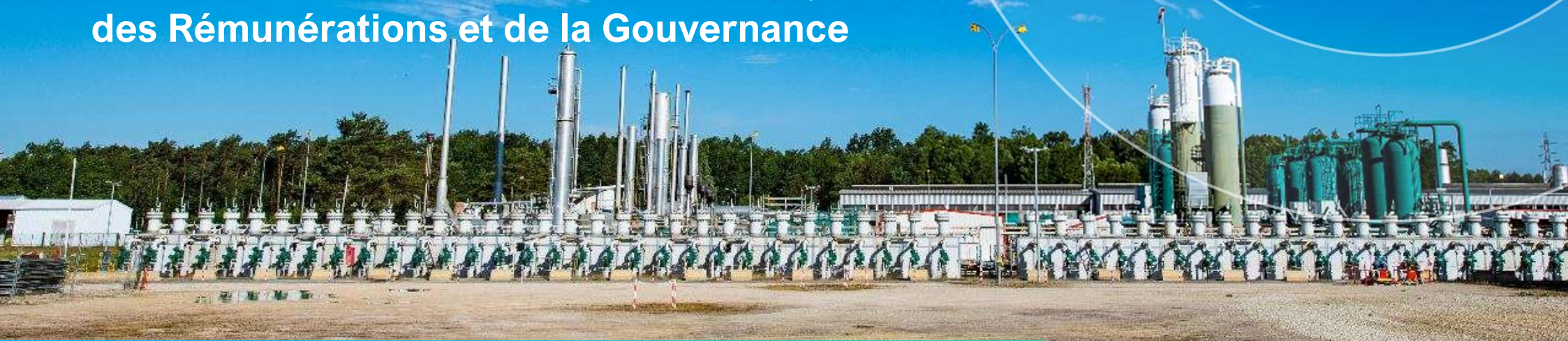
Stockage souterrain de gaz naturel Storengy de Chémery - France
